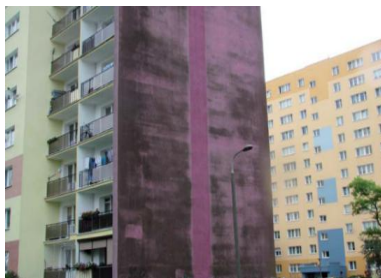
Rys. 3. Zawilgocenie ściany szczytowej budynku wielkopłytkowego
