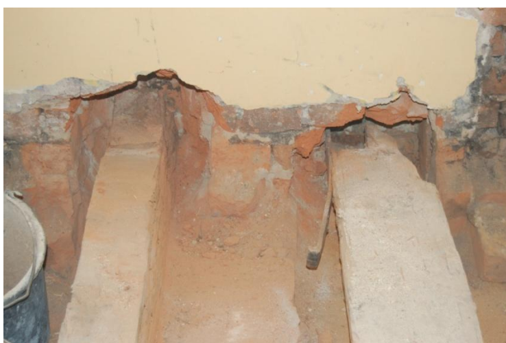
Rys. 5. Przegniła drewniana belka stropowa (po prawej) w wyniku źle funkcjonującej rury spustowej na zewnątrz budynku
