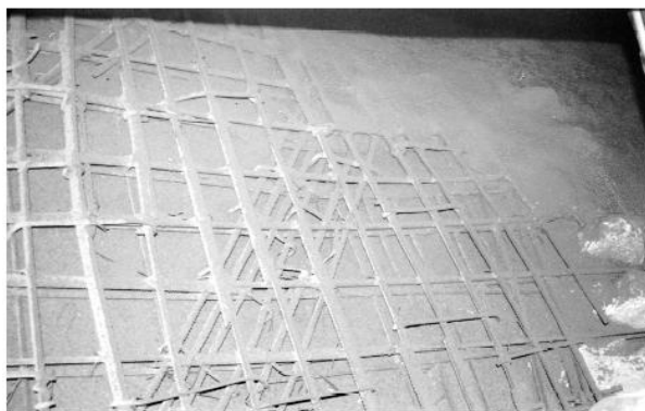
Rys. 2 Fragment zatorkretowania zbrojenia. Widoczne zbrojenie żebra ukrytego [7]
