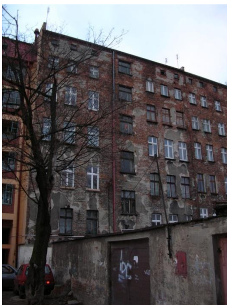
Rys. 4. Przykład zniszczonej elewacji
