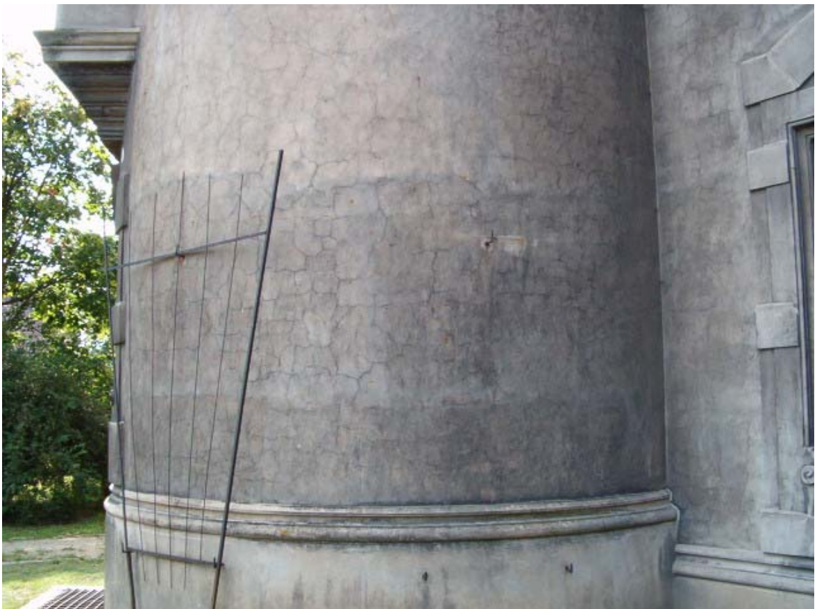
Fot. 108. Spękania tynku południowej cylindrycznej wieży.
