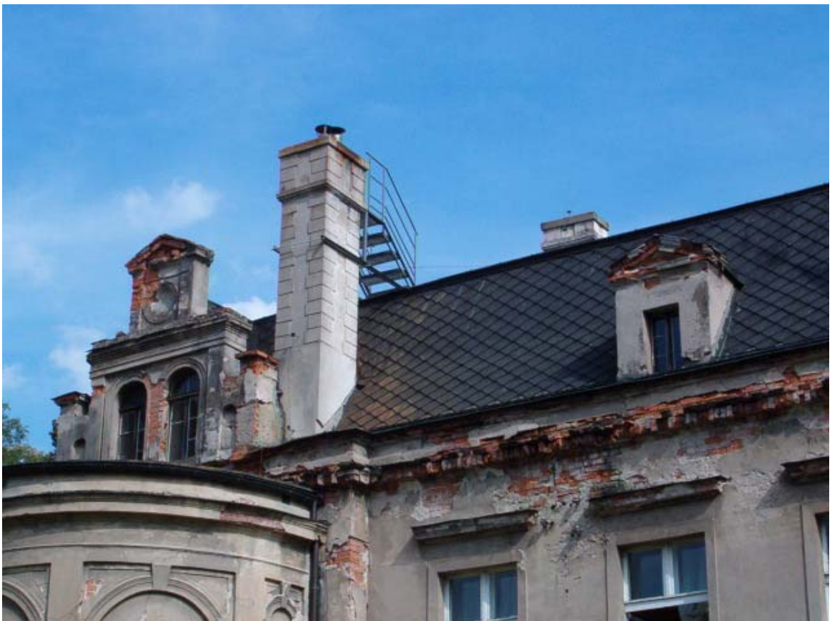
Fot. 115. Ubytki w tynku i murze w bocznej północnej części elewacji zachodniej (ogrodowej).
