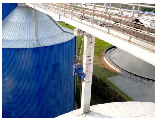
Fot. 1. Zarysowany słup stanowiący podporę pomostu komunikacyjnego łączącego komory fermentacyjne we Wrocławskiej Oczyszczalni Ścieków
