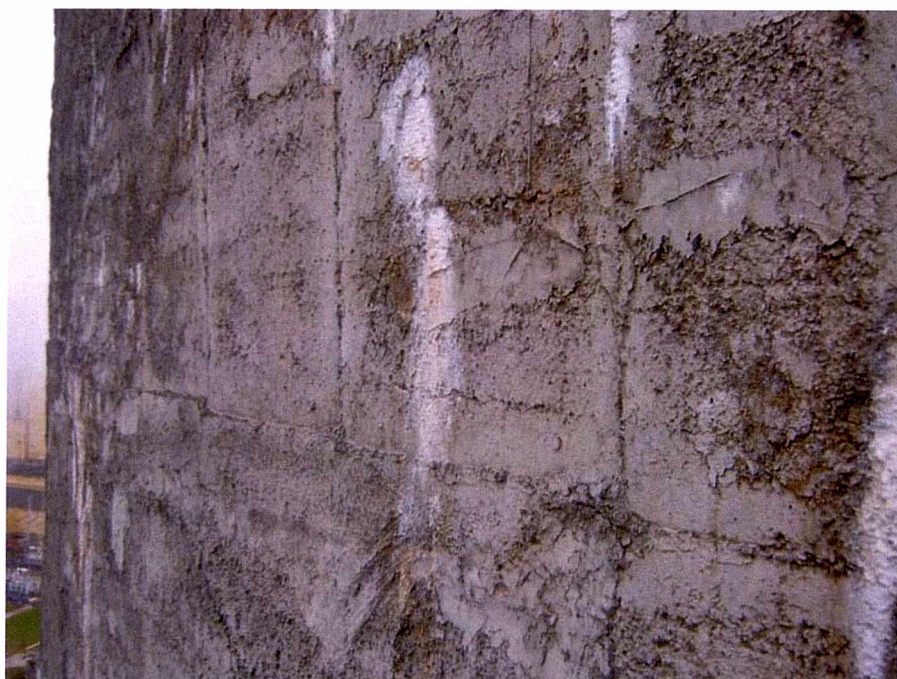
Rys. 3.11. Wyciek na powierzchni zewnętrznej powłoki chłodni (kolory: ciemny i jasny)
