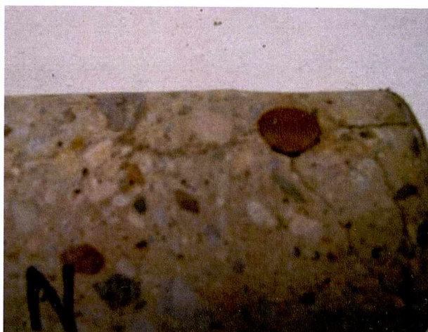
Rys. 3.19. Próbk rdzeniowa z wyraźnymi spękaniami
