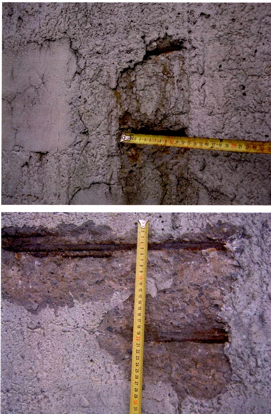
Rys. 3.16. Bardzo płytko osadzone zbrojenie (prawie bez otuliny)
