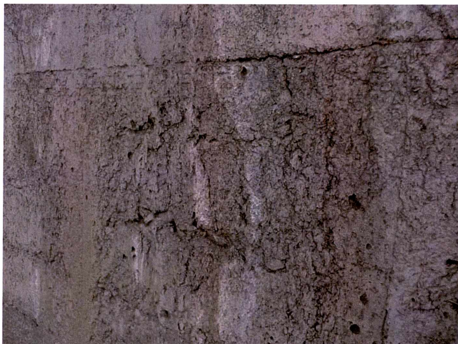
Rys. 3.13. Spękania i wyraźne rysy na materiale rodzimym powłoki chłodni
