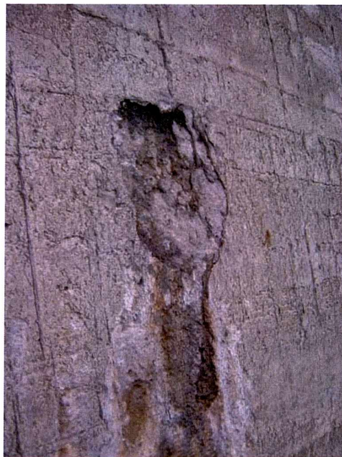
Rys. 3.7. Przykłady: a) powierzchniowego złuszczenia betonu b) powierzchniowego odspojenia betonu
