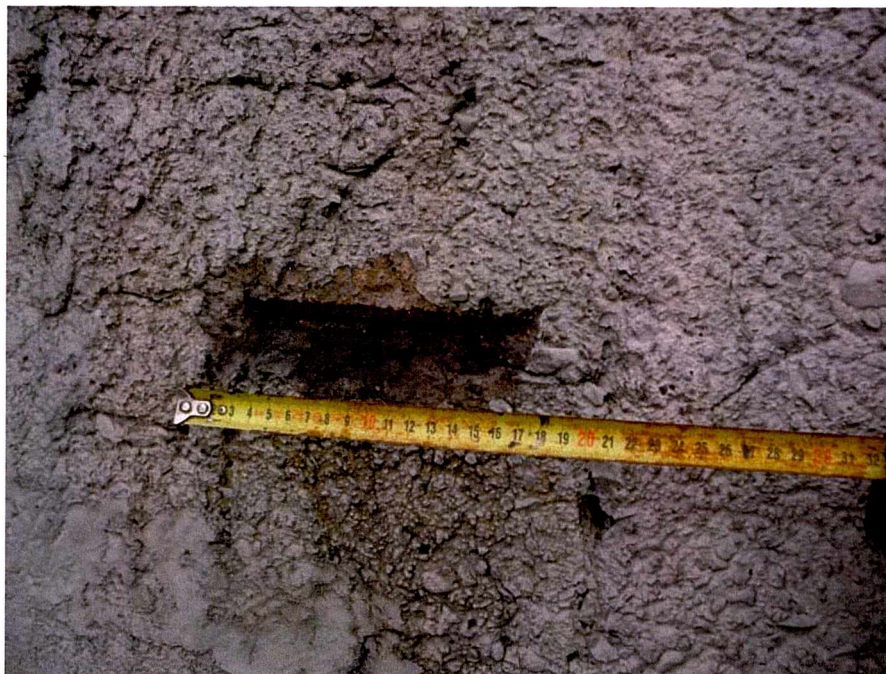
Rys. 3.8. Przykłady: a) powierzchniowego odspojenia i złuszczenia betonu, b) liniowego odspojenia betonu (widoczny odsłonięty pręt zbrojeniowy na długości ok. 16 cm)
