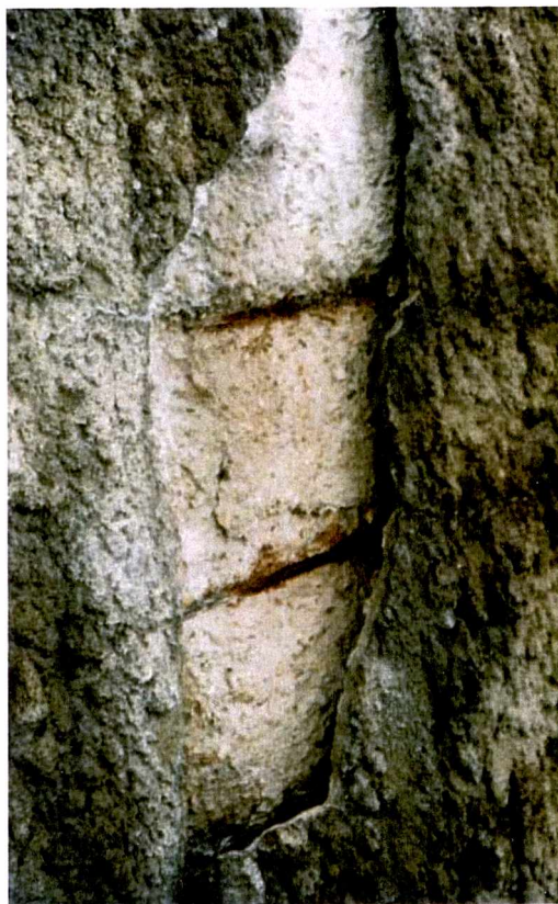
Rys. 3.17. Odspojenia warstwy narzuconego torkretu
