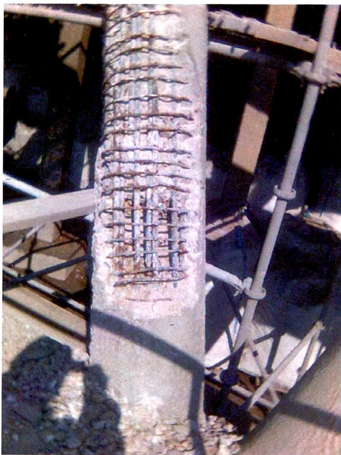
Rys. 3.18. Wykruszony beton z wnętrza słupa chłodni
