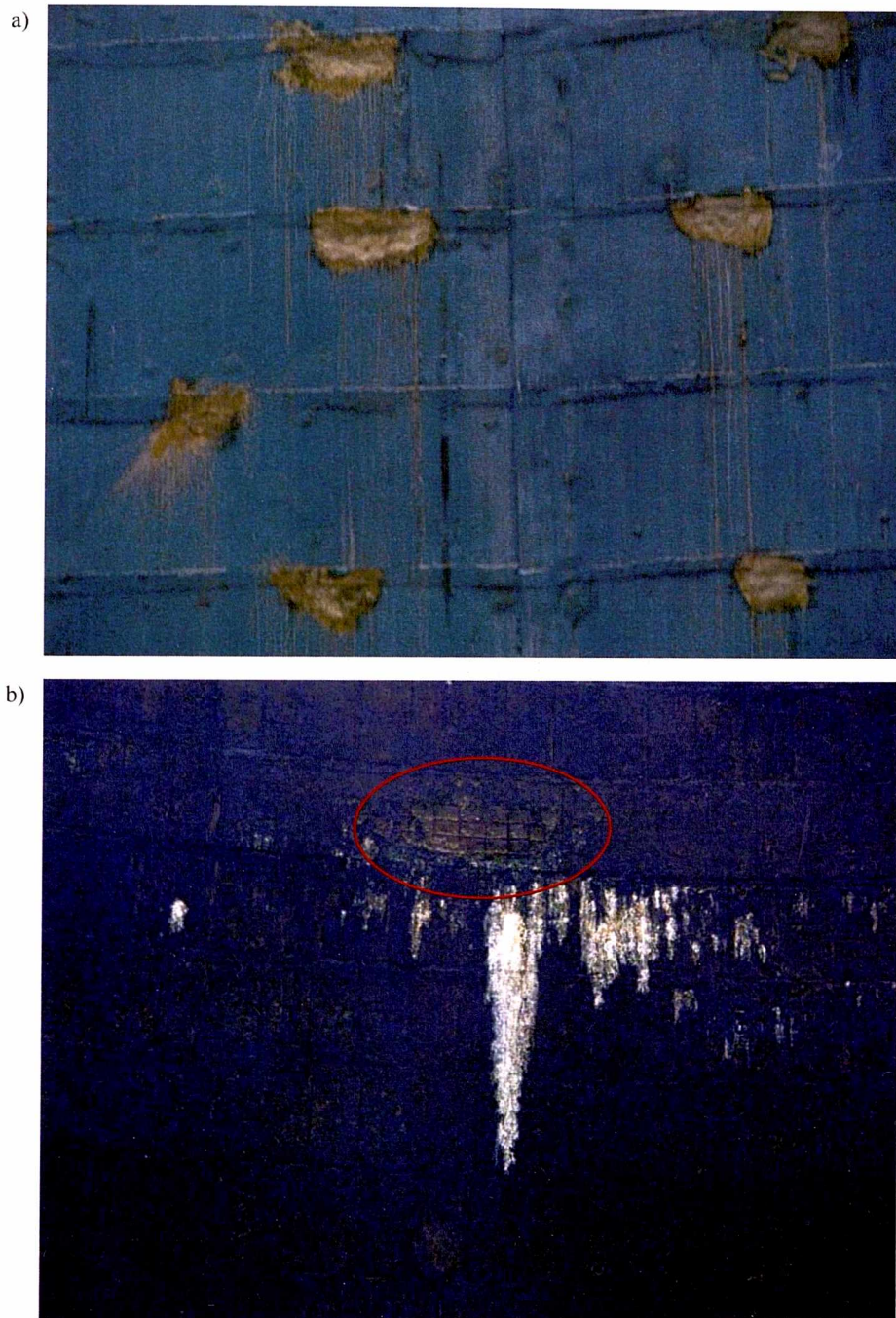
Rys. 3.9. Na powierzchni wewnętrznej chłodni: a) przykład wykonanej naprawy ubytków, b) duży powierzchniowy ubytek betonu oraz białe nacieki węglanu wapnia
