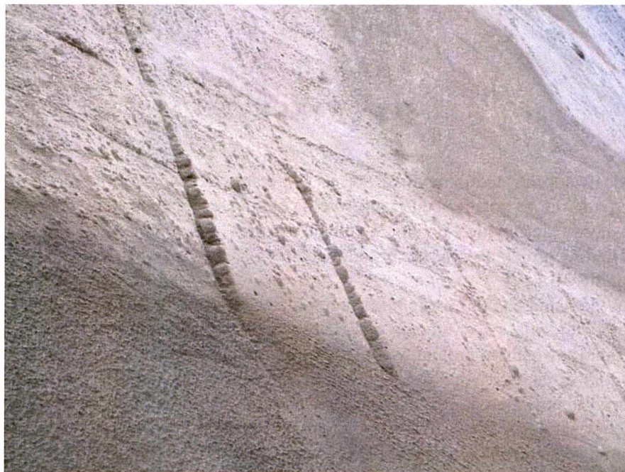
Rys. 3.1. Skutek nieszczelnych szalunków pomiędzy cyklami betonowania (a), uskoki pionowe na powierzchni zewnętrznej (b)
