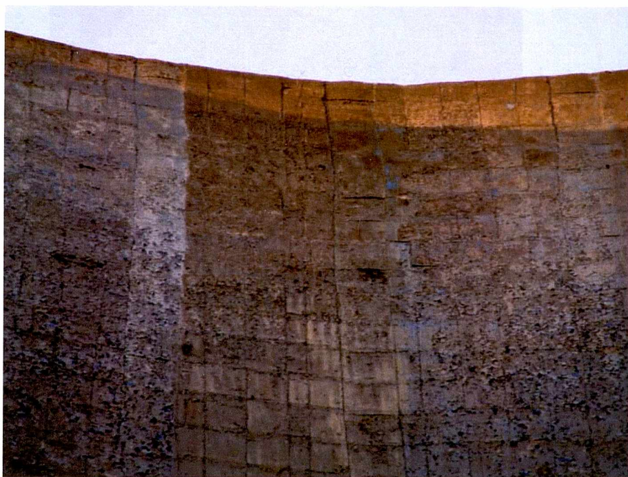
Rys. 3.21. Narośla, uszkodzenia i ubytki powłoki ochronnej chłodzi
