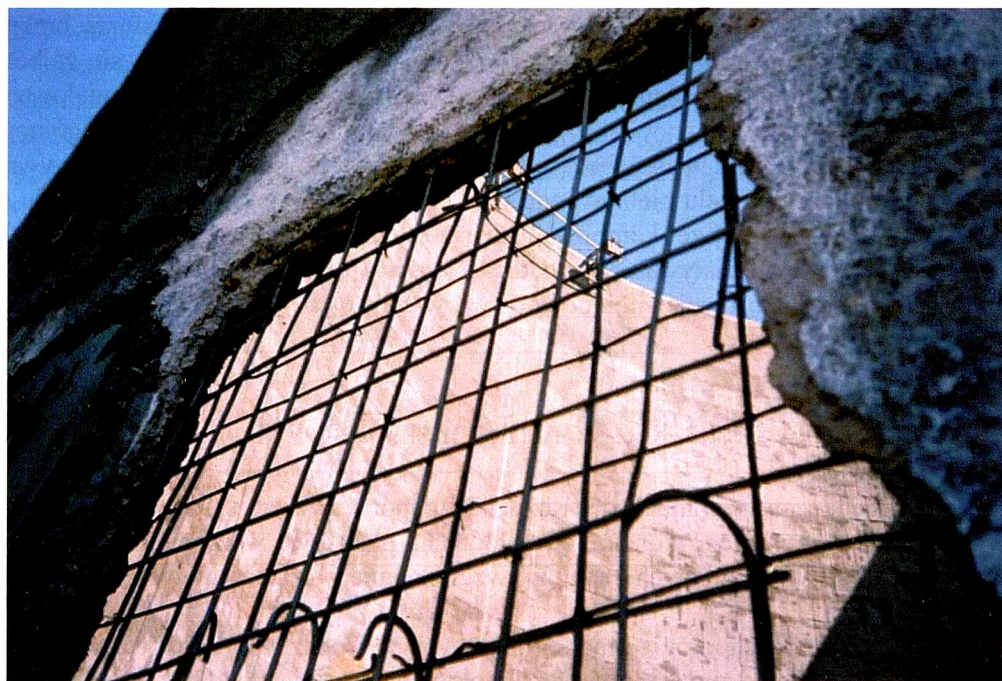
Rys. 2.13. Usunięty całkowicie zdegradowany beton oraz widoczny odspojony torkret narzucony podczas wcześniejszego remontu
