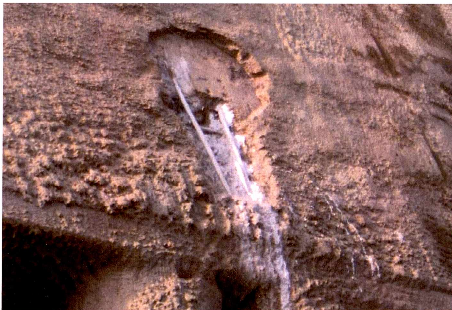
Rys. 2.8. Przykłady: a) odspojona część narzuconego wcześniej torkretu, b) odczyszczone i zabezpieczone zbrojenie, które korodowało pod warstwą torkretu
