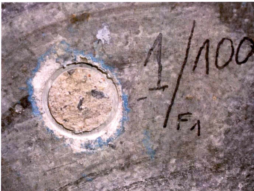
Rys. 3.26. Ciąg dalszy przykładu dokumentowania badań pull-off (przypadek zdegradowanej powierzchni wewnętrznej powłoki chłodni)
