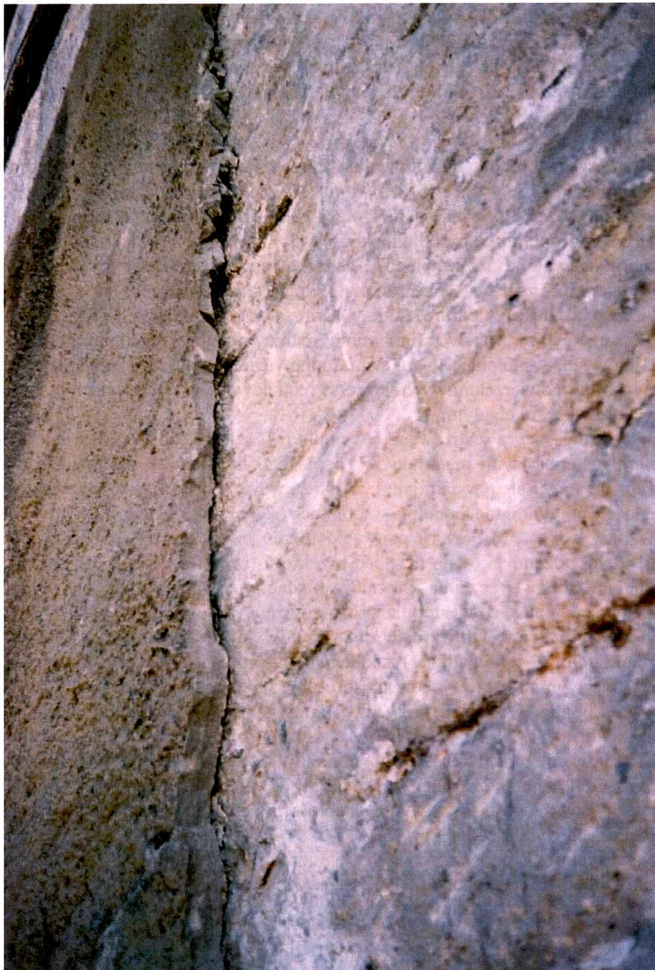
Rys. 1.2. Wyraźnie odspojony beton nałożony na materiał rodzimy wraz z widoczną korozją zbrojenia
