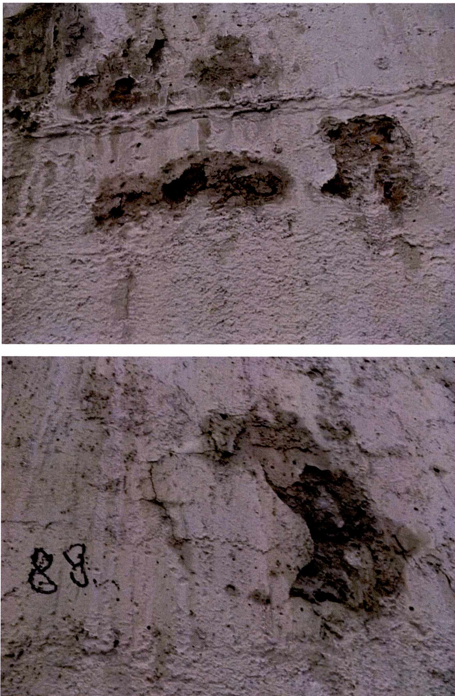
Rys. 3.10. Przykłady ubytków materiału rodzimego
