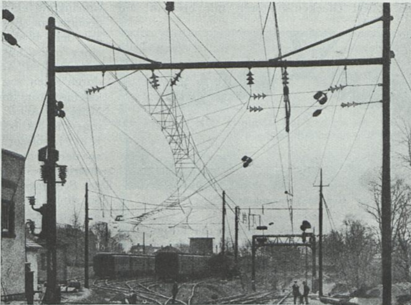
Abb. 86. Kettenwerk einer Bahnhofsanlage mit Hängeisolatoren mit aufgekitteten Kappen. 11000 V. (West.)
