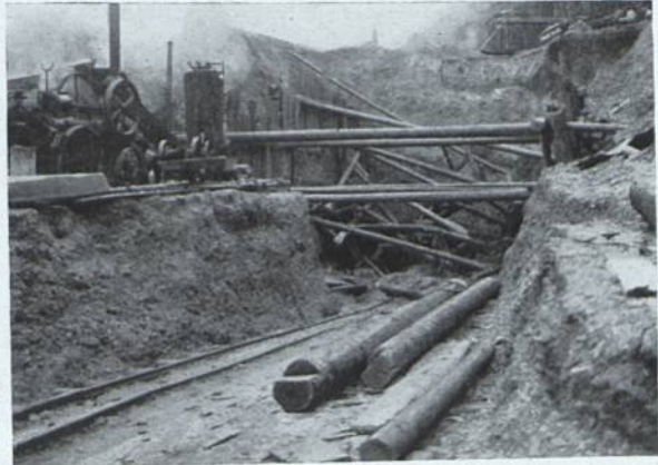
Abb. 42. Einsturz der bergseitigen Einrüstung.
