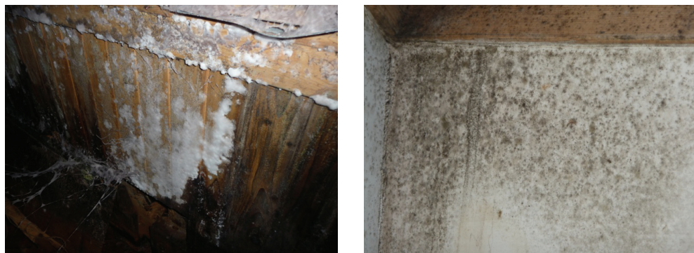
Rys. 6.18. Grzyby pleśniowe widoczne na elementach budynków: na okładzinie drewnianej (a) i na tapecie ściennej (b) [fot. B. Stawiski]
