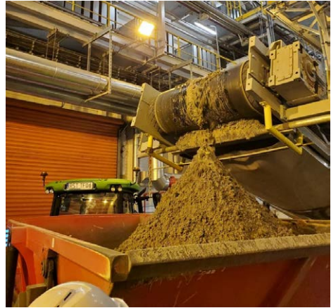
Rys. 2.4. Awaryjny zrzut żużla: żużel powinien być w formie wypalonych grudek (dobre spalanie), a był mokry po hydrotransporcie
