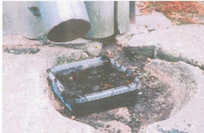
Rys. 31. Przykład zanieczyszczeń naniesionych wraz ze spływem z dachu pobranym we Wrocławiu w kwietniu 2004 r.
