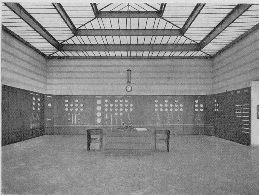
Rys. 3. Nastawnia przetwórnicy Chorzów.
