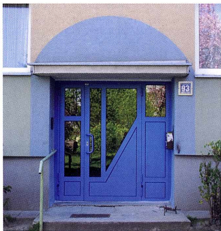
Il. 4.86. Osiedle Huby, ul. Wiczysta 93. Nieudane rozwiązanie wejścia do klatki schodowej po termomodernizacji (fot. B. G.)
