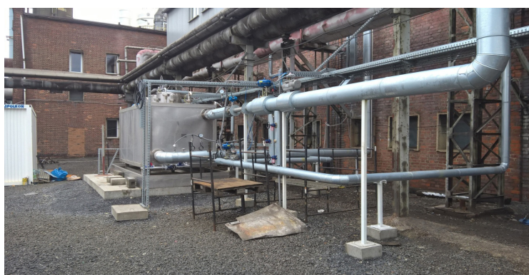
Rys. 6.41. Widok układu zasilania magazynu parą
