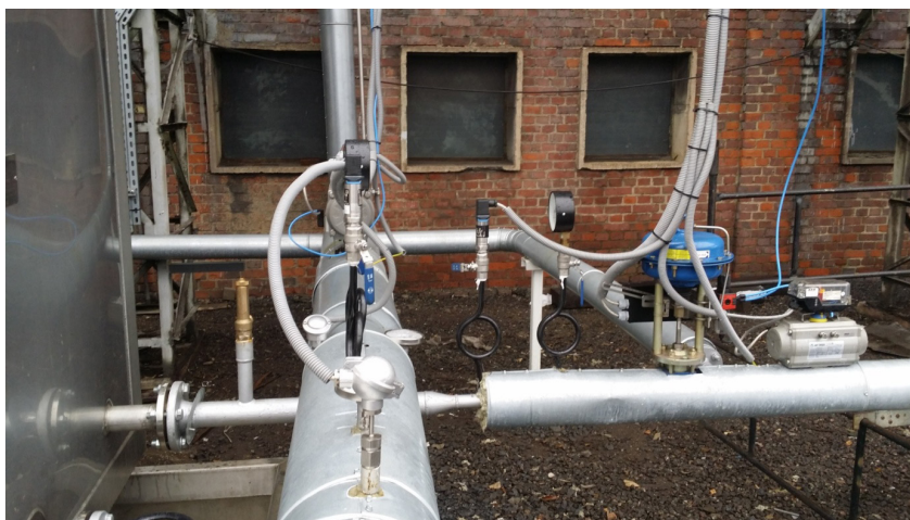
Rys. 6.43. Widok układu wodnego pilotażowej instalacji z magazynem ciepła
