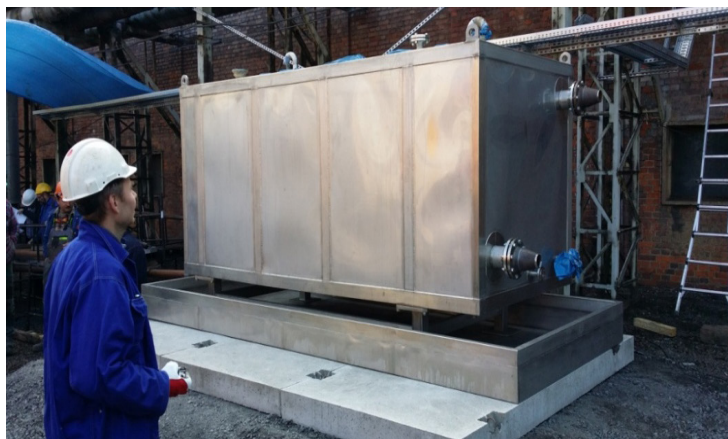
Rys. 6.36. Magazyn ciepła posadowiony na fundamencie w wannie zabezpieczającej przez wyciekem soli
