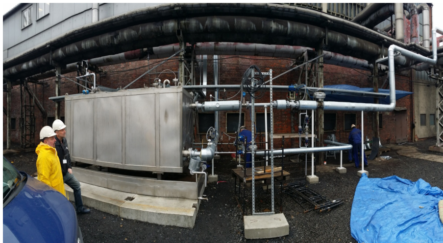
Rys. 6.44. Instalacja pilotażowa ze zmiennofazowym magazynem ciepła
