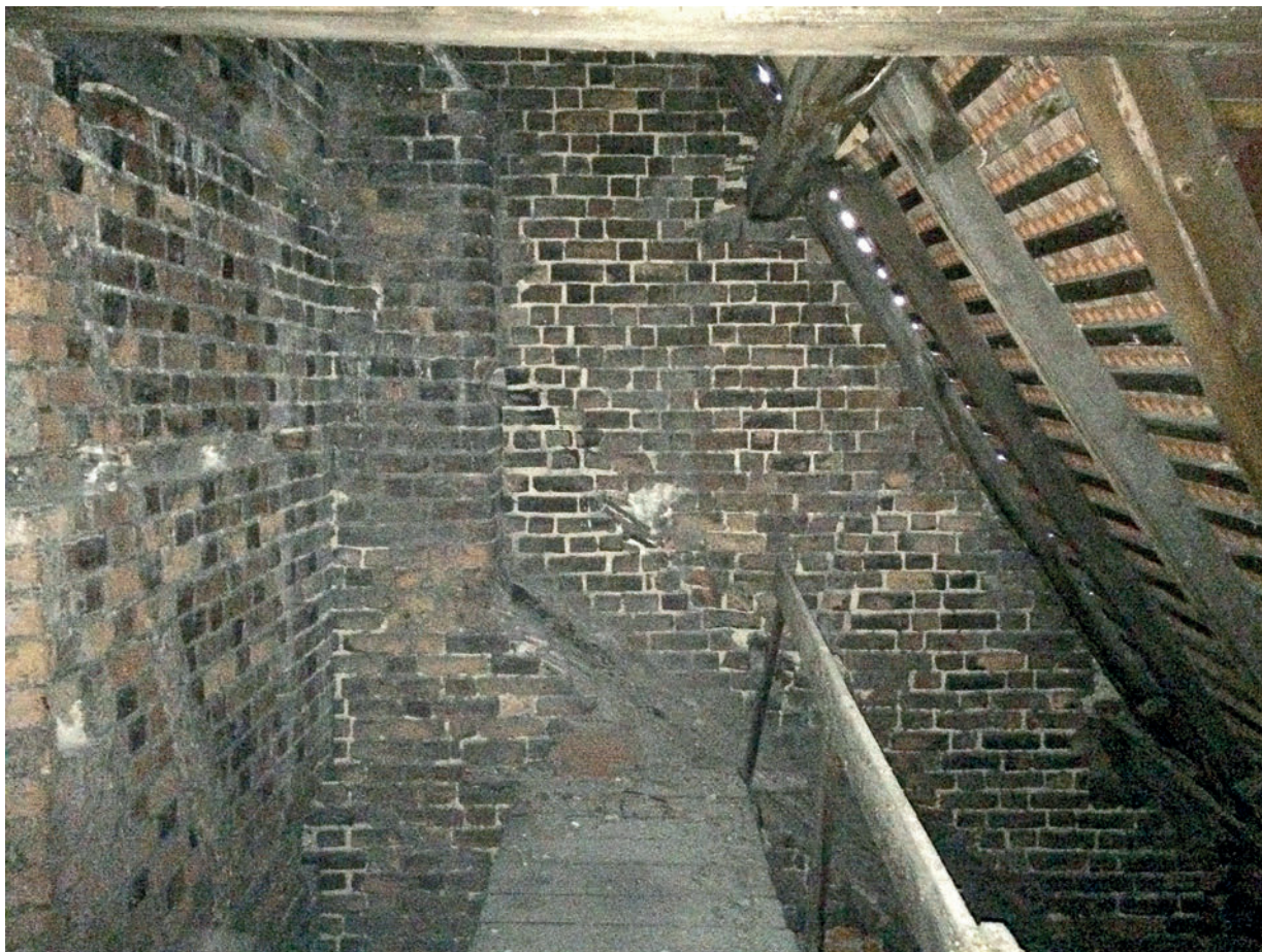
Il. 159. 2022 r. Strychy – ściana zachodnia nad nawą północną; fot. A.H.
