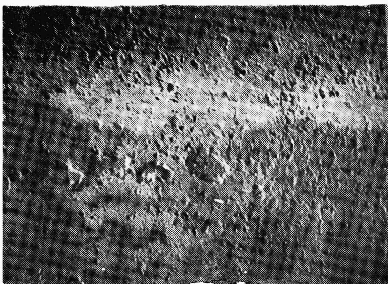
Fot. 5. Wżery uwidocznione na fot. 4 i 6 po rocznej eksploatacji kutra od czasu metalizacji. Zdjęcie wykonane bezpośrednio po wyciągnięciu kutra i obmyciu go wodą bez szczotkowania (wielkość naturalna).
