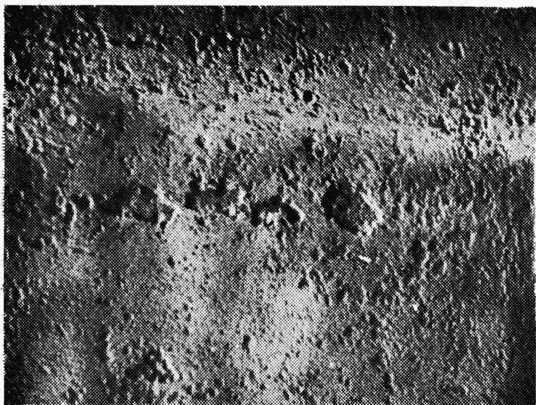
Fot. 4. Głębokie wżery uwidocznione na fot. 6 bezpośrednio po nałożeniu warstwy ochronnej cynku (wielkość naturalna).
