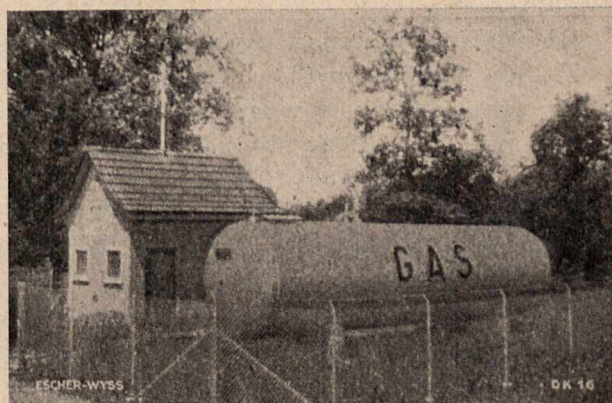
Rys. 9. Zbiornik gazowy na wysokie ciśnienie w Burgdorf.
