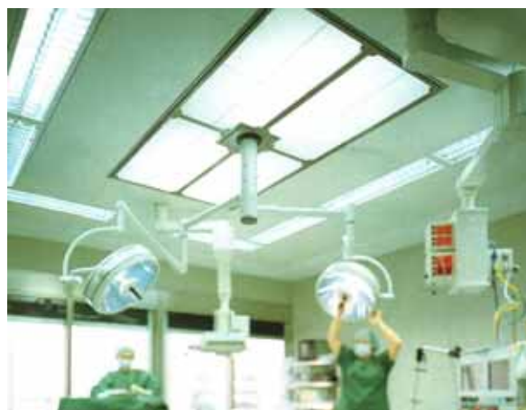
Rys.2.2 Sala operacyjna z nawiewnikiem - tego samego typu jak w DCO we Wrocławiu
