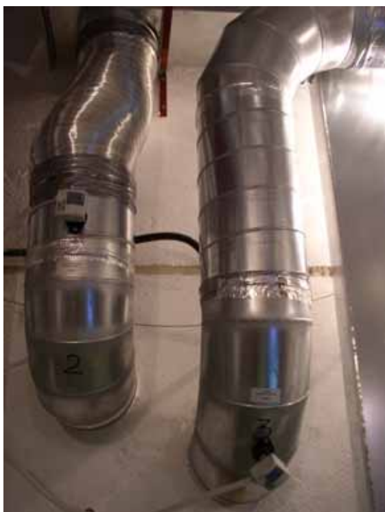
Rys. 2.56 Zbiorniki kanały: nawiewny nr 3 oraz wywiewny nr 2, a w nich umieszczone czujniki pomiarowe QAM 22 (Siemens)
