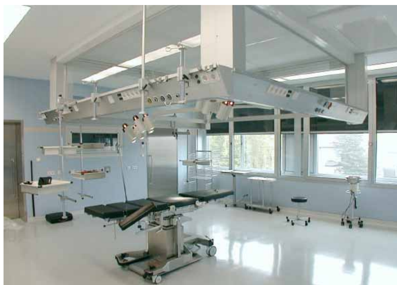
Rys.1.61 Prostokątny strop laminarny typ OP z kurtynami bocznymi oraz mostem anestetycznym firmy ADMECO AG [139]
