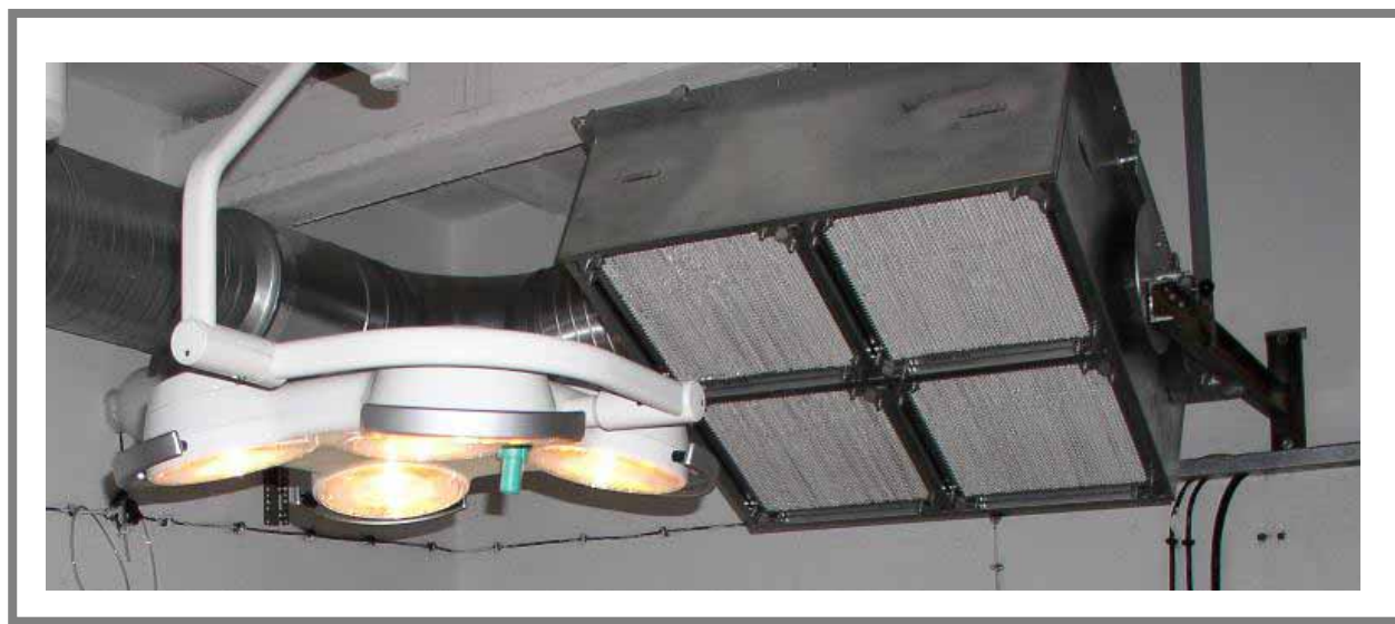
Rys.2.47 Nawiewnik SLANtinG na stanowisku laboratoryjnym; widoczny jest przewód, doprowadzający powietrze do nawiewnika oraz załączona lampa bezcieniowa
