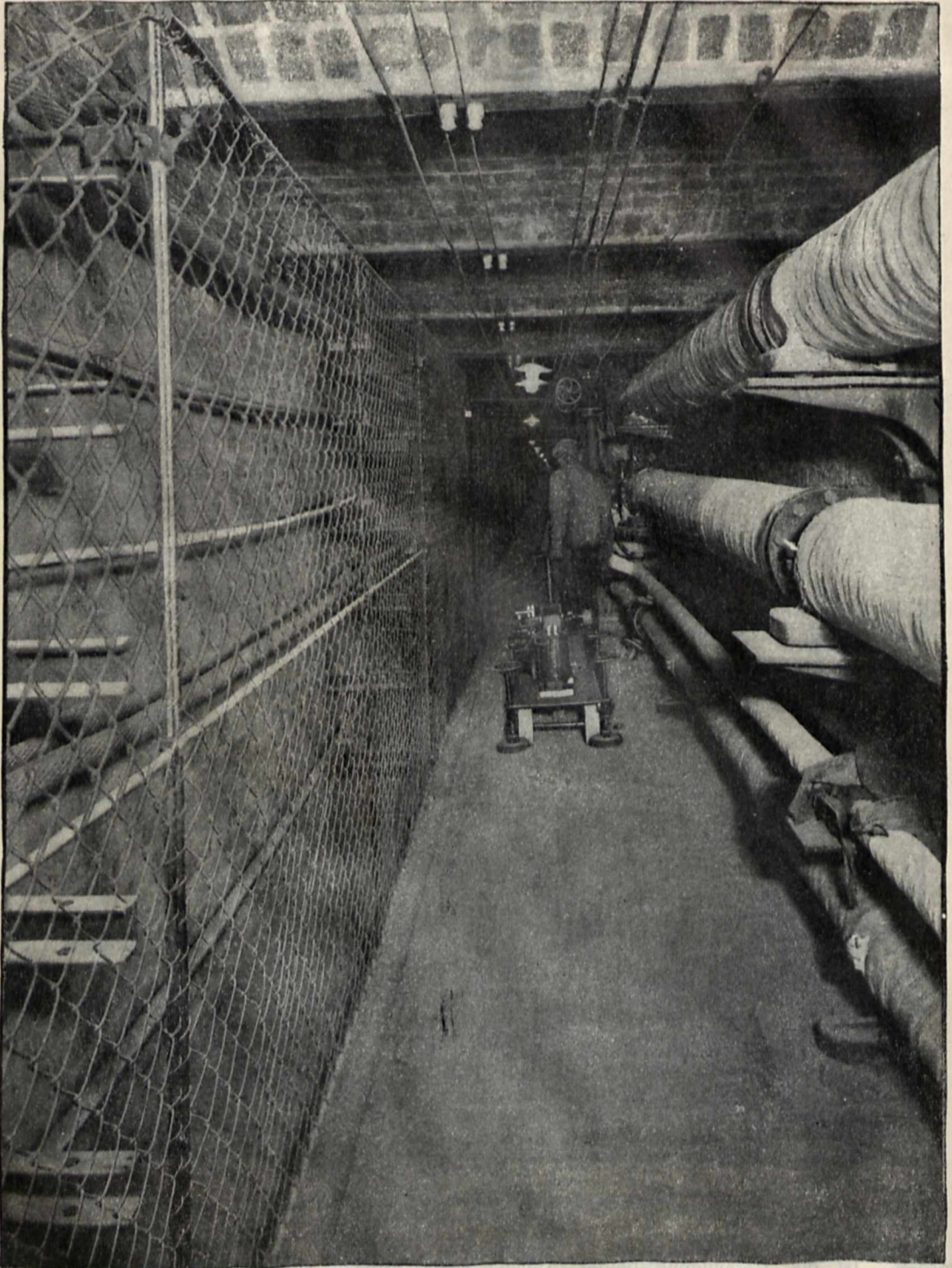
Das königliche Fernheiz- und Electricitätswerk in Dresden: Blick in den Kabel- und Rohrcanal. Links die Kabelleitungen, rechts die Heizrohre. In der Mitte der fahrbare Elektromotor.
