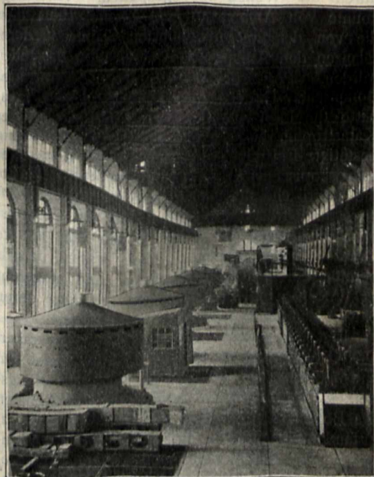
Die neue Kraftstation der Niagara Power Company: Die Generatoren.
