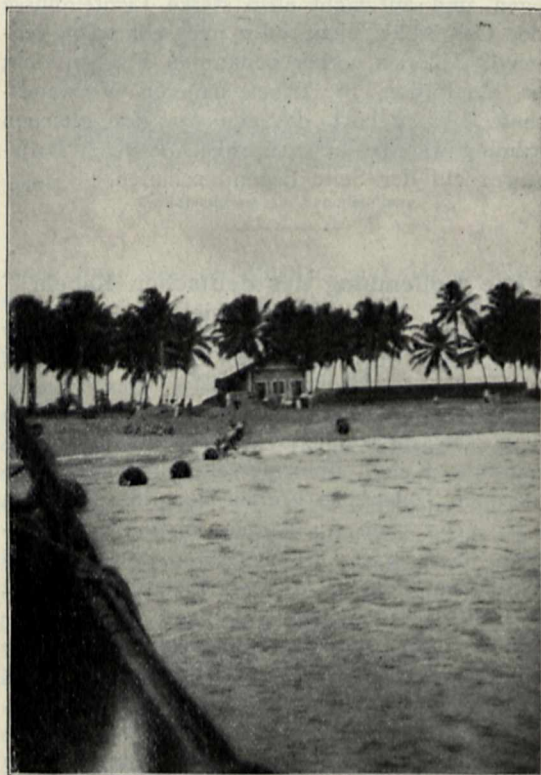
Landung des Küstenkabels an der brasilianischen Küste und Einführung in das Kabelhaus der Deutsch-Südamerikanischen Telegraphengesellschaft am 2. März 1911.
