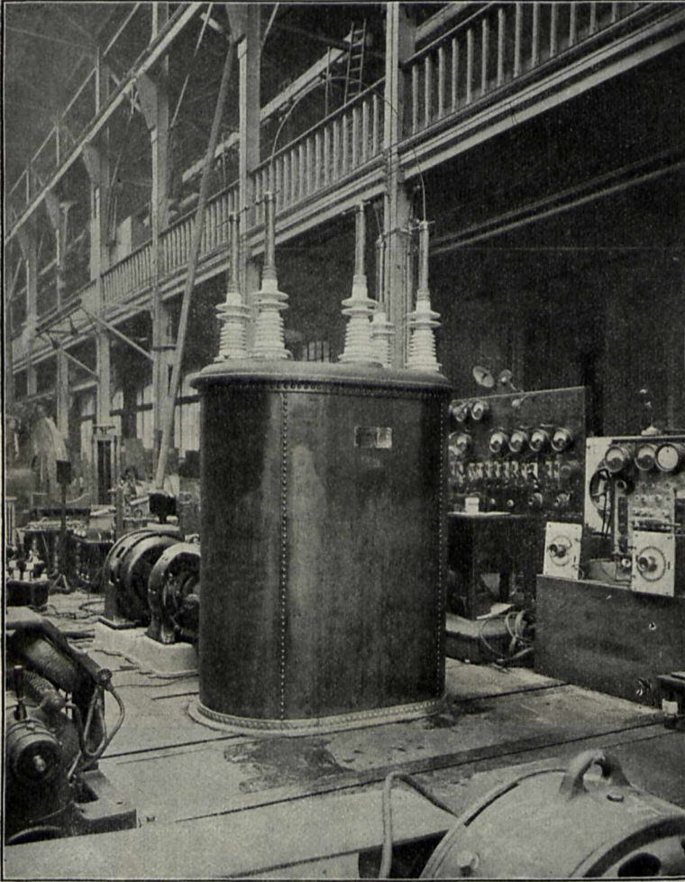
Ein Hochspannungstransformator für 250 000 Volt zum Prüfen von Isolatoren.
