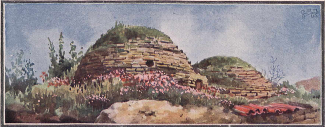
Fig. 4. Ein altes Bad in Angora in starkem Verfall; es dient heute als Petroleum-Magazin. Die Flachziegeltechnik der Wölbung ist gut zu sehen; die frühere Eindeckung mit riesigen Bleiplatten oder Dachziegeln ist verschwunden.
