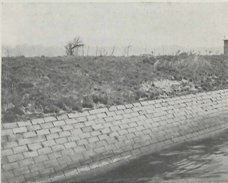
Fig. 1. Von Wühlmäusen schwer beschädigter Damm.
