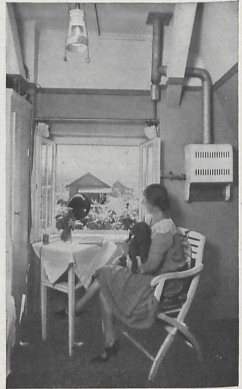
Fig. 2. Gasheizung in einem Sommerhäuschen in Berlin-Zehlendorf.
