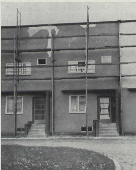
Fig. 3. Die übliche Ausbesserung unter dem oberen Gesims, gleich nach dem Einzug der Mieter. Die gleichen Schäden treten trotz wiederholter Reparaturen immer wieder auch an sämtlichen anstoßenden Bauten auf.
