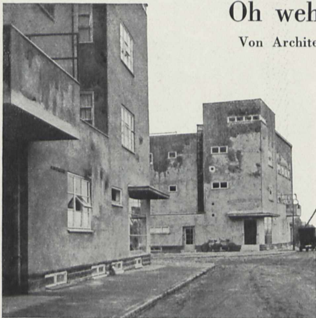
Fig. 1. Krankes Mauerwerk, durchnäßte Bauten, die ständige Reparaturen erfordern.
