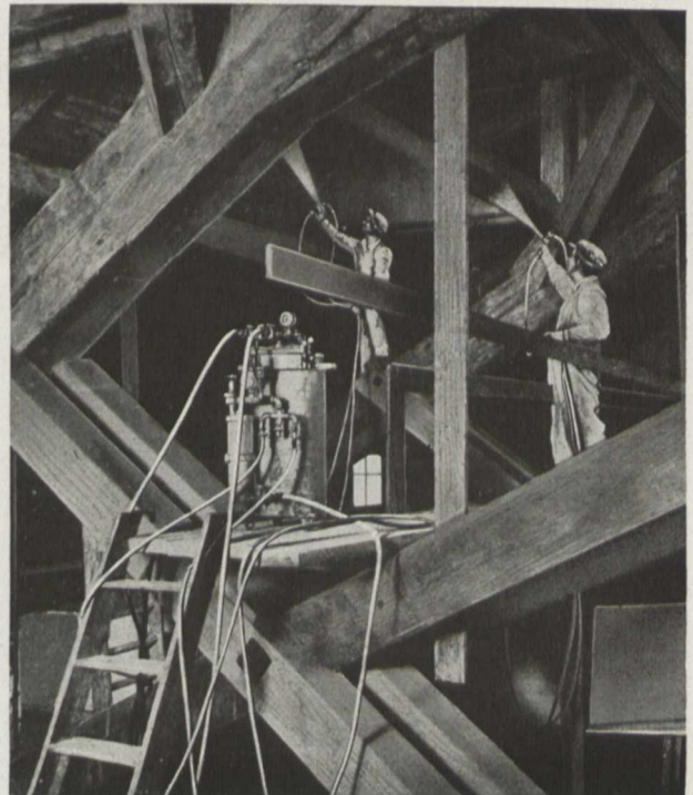
Fig. 1. Der Dachstuhl der Berliner Staatsoper wird zum Schutz gegen Feuer mit „Cellon-Feuerschutz“ bespritzt
