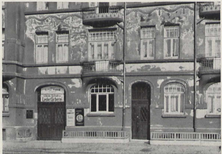
Fig. 5. Dieses pockennarbige Haus ist nicht so schwer leidend wie es aussieht. Minderwertiger Zierputz ist die Ursache des frühen Verfalles seines Außern.
