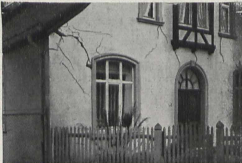
Fig. 2. Fehlerhaftes Verputzen alten Fachwerks Sowohl der große Riß wie die kleineren darunter bereiten immer weiteren Verfall vor. Der in die Risse eindringende Regen wird ihn noch beschleunigen.
