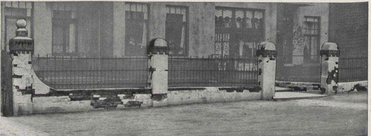
Fig. 3. Einfriedigungen aus Backsteinen, die nicht wie Klinker bis zum Sintern gebrannt sind, frieren in wenigen Jahren entzwei. Der Verputz fällt ab, die Steinbrocken folgen. — Nur Pfeiler und Sockel aus Hartgestein oder Stampfbeton sind von Dauer.
