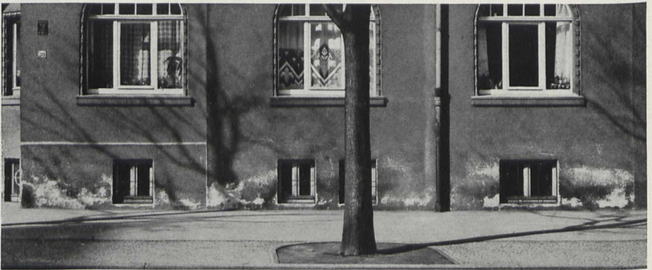
Fig. 7. Der häßliche Zustand am Gebäude über dem Bürgersteig entsteht durch Herabziehen des Fassadenputzes bis zur Erde. Er wird vermieden durch ein hartes Verblendmauerwerk als Sockel.
