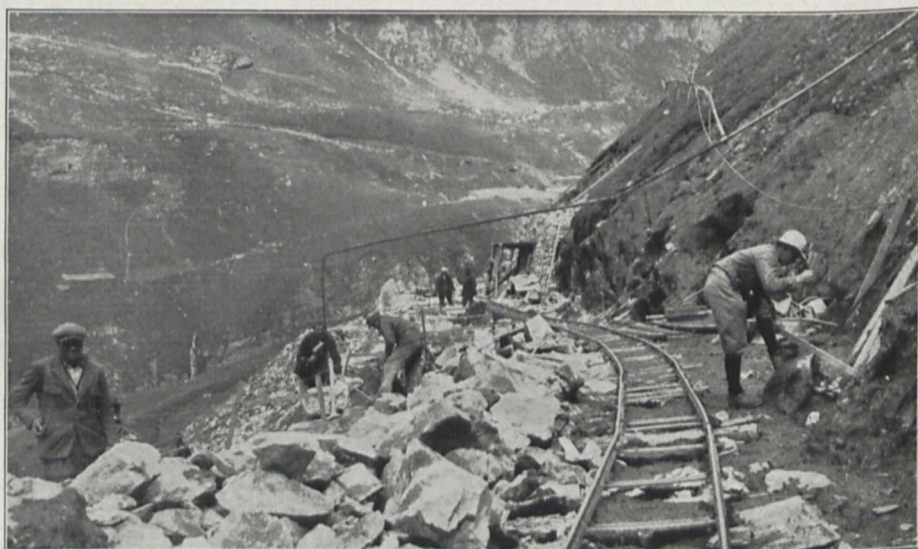
Fig. 6. Einebnen des schwierigsten Straßenteils, der 6 km langen Gipfelstrecke, beim Glocknerhaus in 2100 m Seehöhe
