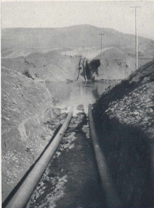
Bild 2. Die doppelte Rohrleitung von 25 cm Durchmesser kreuzt den Jordan
