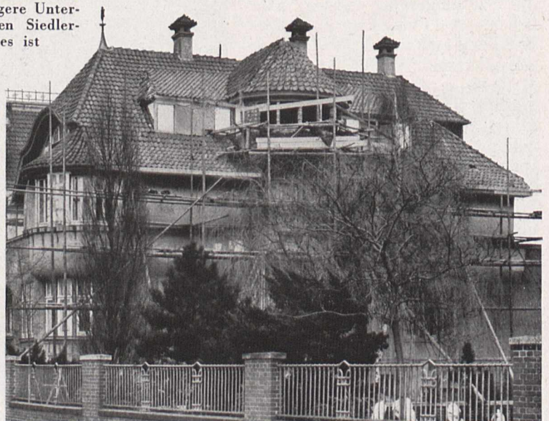
Bild 9. Die ohnehin unruhige Dachfläche wird durch Einbau weiterer Dachwohnungen völlig zerstört
