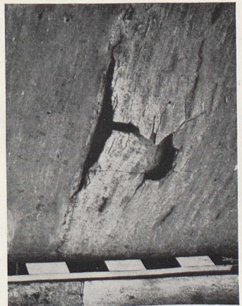
Bild 2. Schalenbildung bei Grün sandstein. Aufplatzen der Schale infolge Volumenvergrößerung
