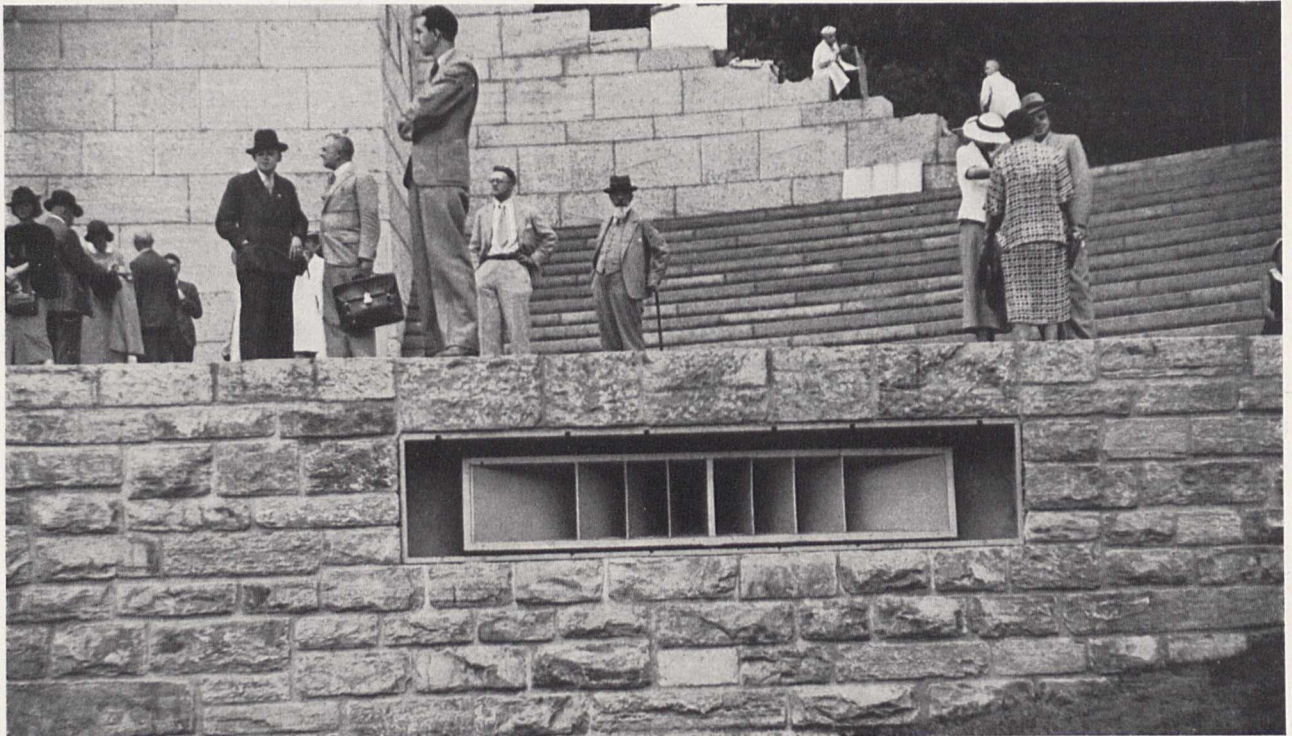
Bild 4. Eingebauter breitstrahlender Lautsprecher
