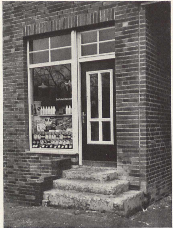
Bild 8. Eine Menschenfalle: Die Abtreppe mündet hart an einer Durchfahrt, links neben der zu niedrigen Trennwange ist ein Kellerschacht Sämtliche Bilder: Verfasser
