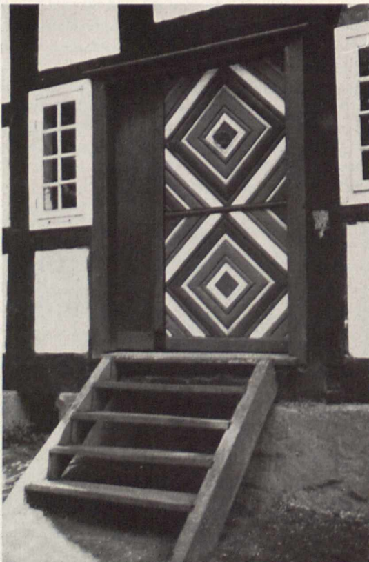
Bild 6. An dieser Treppe fehlt das Geländer Bramsche, nördlich Osnabrück
