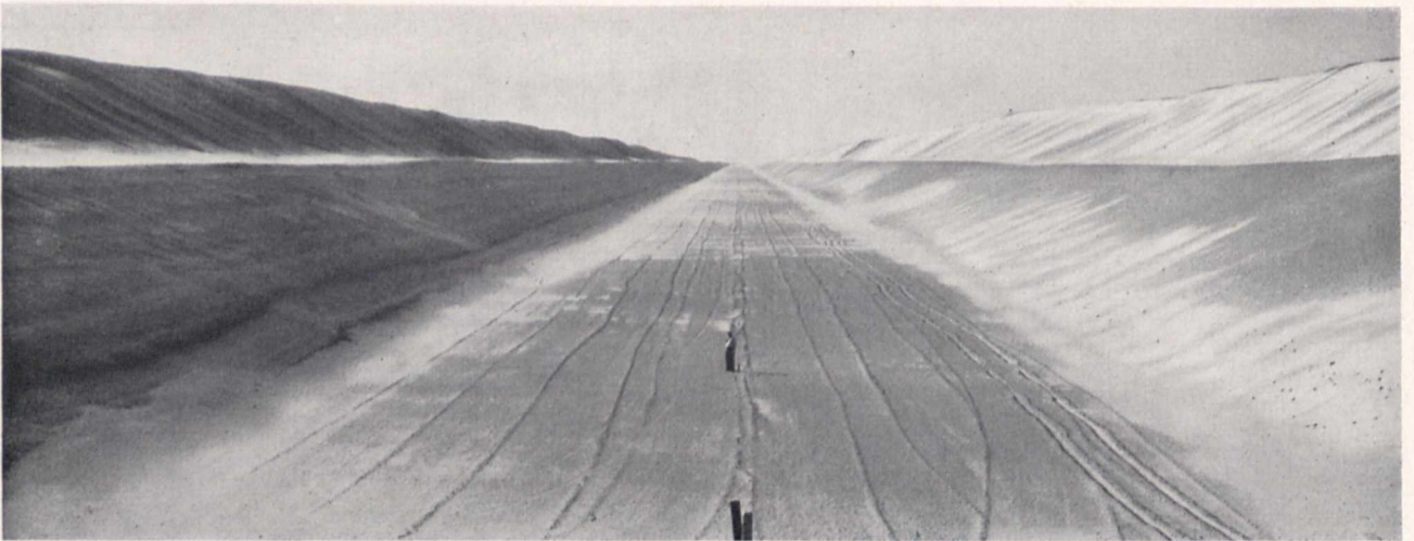
Bild 4. Das Bett des All-Amerika-Kanals in der Sandwüste von Arizona. — Der Kampf mit dem Flugsand bereitet große technische Schwierigkeiten. Der Kanal ist an dieser Stelle 66 m breit. Nun muß noch die Dammbefestigung durchgeführt werden, damit das Bett nicht von Flugsand wieder verschüttet wird
