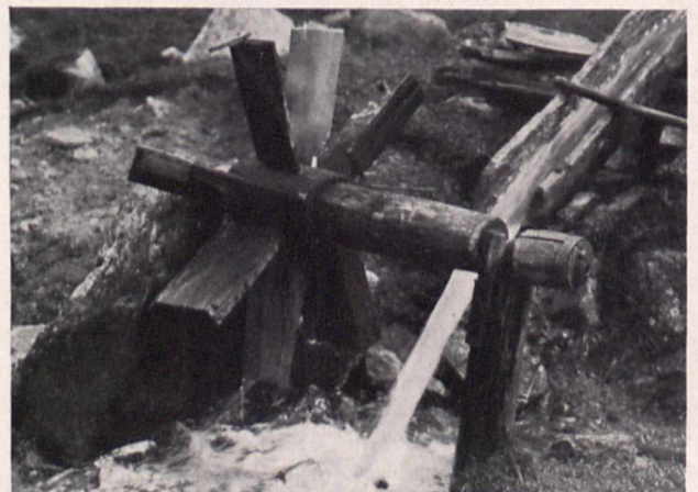
Bild 4. Der „Leerschuß“ ist eingeschaltet. — Das Laufrad ist hier besonders gut zu erkennen. Ebenso die um einen Punkt (Bolzen) an ihrem bergseitigen Ende verschwenkbare „Schieberinne“ mit dem Handgriff zu ihrer Betätigung und dem Gleitblock, der aus geschichteten Steinen und einem Holzschleit besteht. Die Rinne selbst ist ein ausgehöhlter Baumstamm
