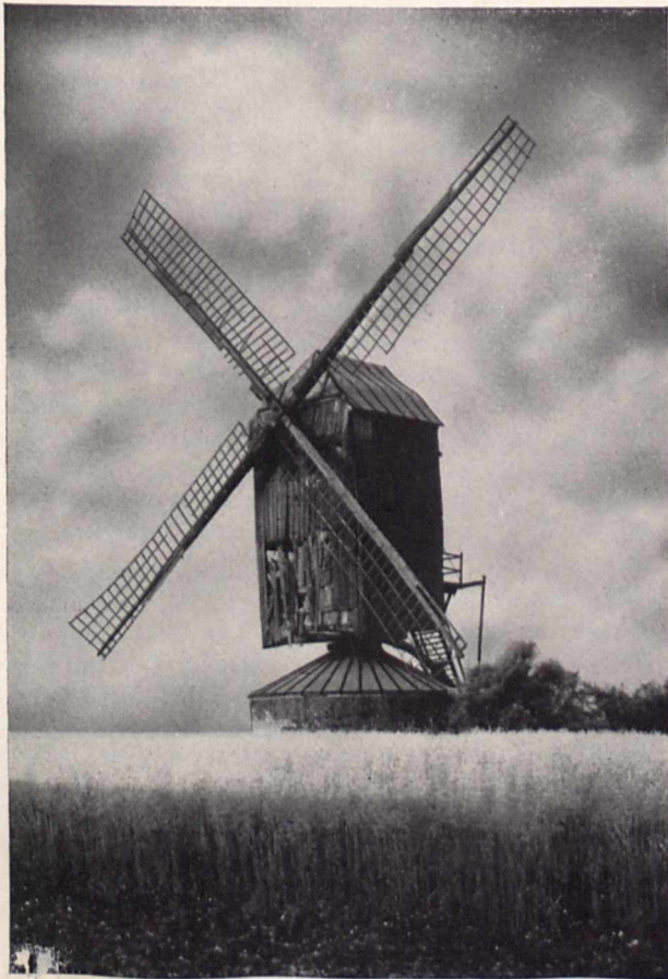
Bild 1. Niederrheinische Bockwindmühle im Zerfall Mühlen in solch verfallenen Zustand erinnern zwar an „vergessene Zeiten“, tragen aber keineswegs zur Verschönerung des Landschaftsbildes bei
