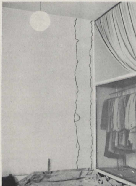
Bild 6. Rißbildung beim Durchbruch eines Giebels (nachgezogen, weil in der Aufnahme zu schwach)
