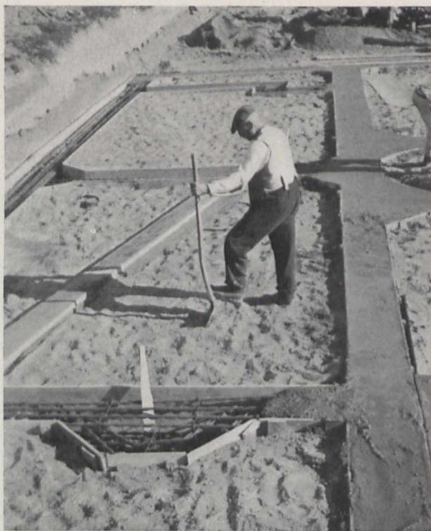
Bild 7. Gründung von Siedlungshäusern im Bergbaugebiet. Die Grundmauern sind durch Rundisen bewehrt.
