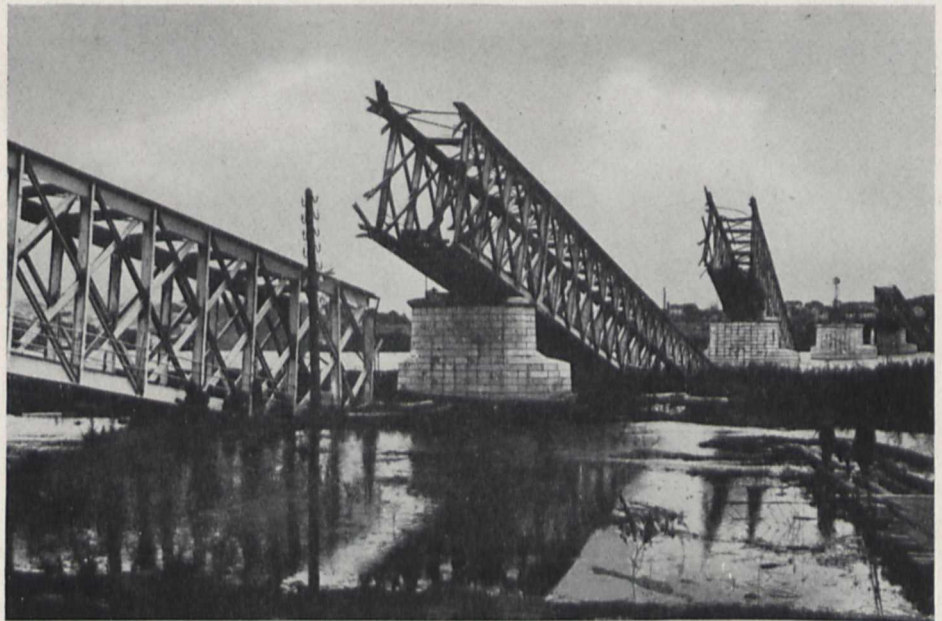
Bild 1. Zerstörte Eisenbahnbrücke über einen Strom.
