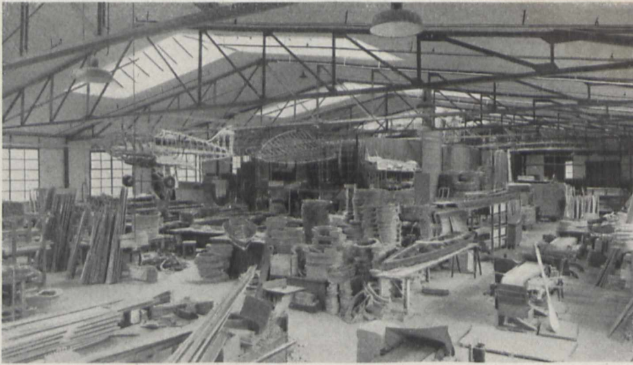
Bild 3. Sprinkleranlage in einer Faltbootfabrik
