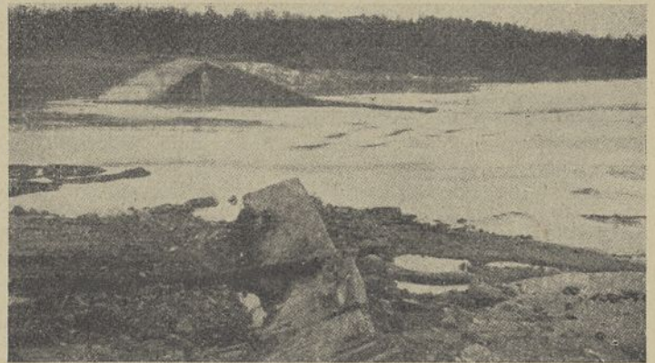
Abb. 43. Dells-Damm, Bruchstelle mit den freigelegten umgestürzten Kernmauerbruchstücken.
