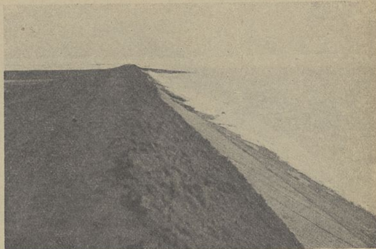
Abb. 24. Böschungsbefestigung vom Eis gehalten, kurz vor der Rutschung.
