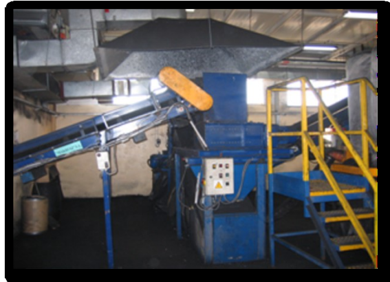
F_ 10. Obróbka mechaniczna zużytych baterii.
