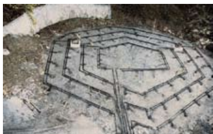
Rys. 3. Górna część podziemnego zasobnika ciepła z fragmentami czterech pierścieni kolektorów obiegu roztworu wodno-glikolowego przez sondy o długości (głębokości) 65 metrów [1,3]
