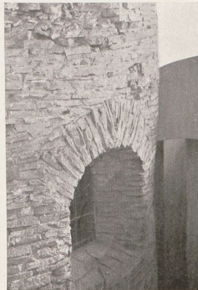
Fig. 2. Szczegół do fig. 1. Zachowany i od zewnątrz widoczny fragment muru z okienkiem apsydy.
