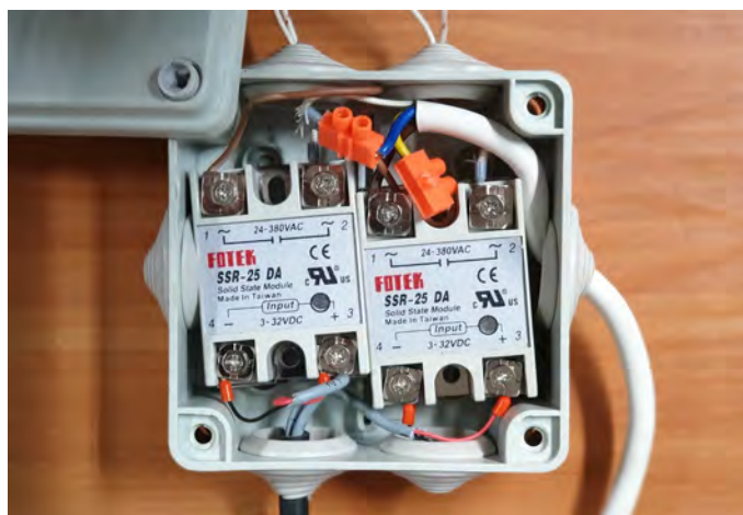
Rys. 5.18 Przekładniki półprzewodnikowe zastosowane do kontroli pracy grzałek elektrycznych.
