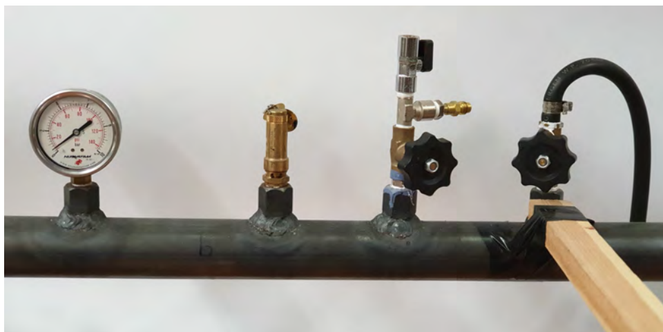
Rys. 5.2 Armatura gazowa przyłączona do rezonatora za pomocą gwintowanych króćców. Od lewej: manometr, zawór bezpieczeństwa, zawór wylotowy gazu, zawór wlotowy gazu.
