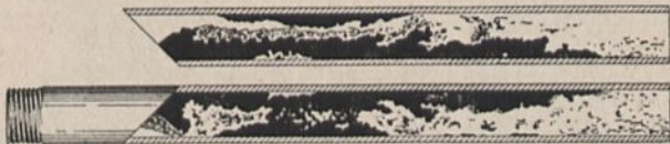
Abb. 6. 1"-verzinktes Rohr mit starker Zinkablagerung. Federzeichnung nach der Natur. Schwarz dargestellt ist das durchschnittene Zink. Die Verstopfung des Rohres ist fast vollständig.
