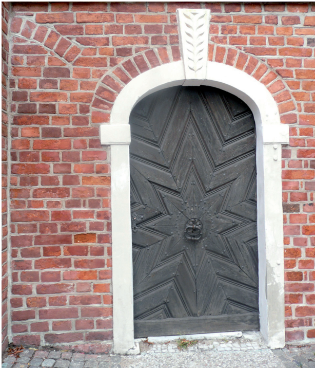
Il. 7. Dawne wschodnie wejście do parteru dawnego budynku gospodarczego po zmianach dokonanych w 1824 r. (fot. A. Piwek)
