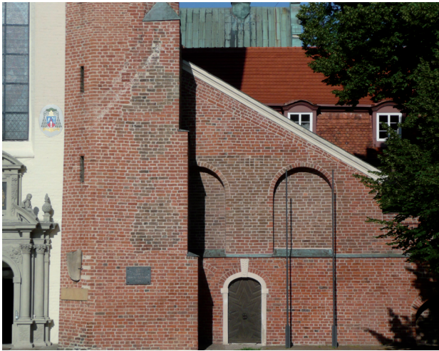
Il. 1. Ściana wschodnia dawnego browaru przyległa do fasady kościoła pocysterskiego w Oliwie. Stan z 2010 r. (fot. A. Piwek)
