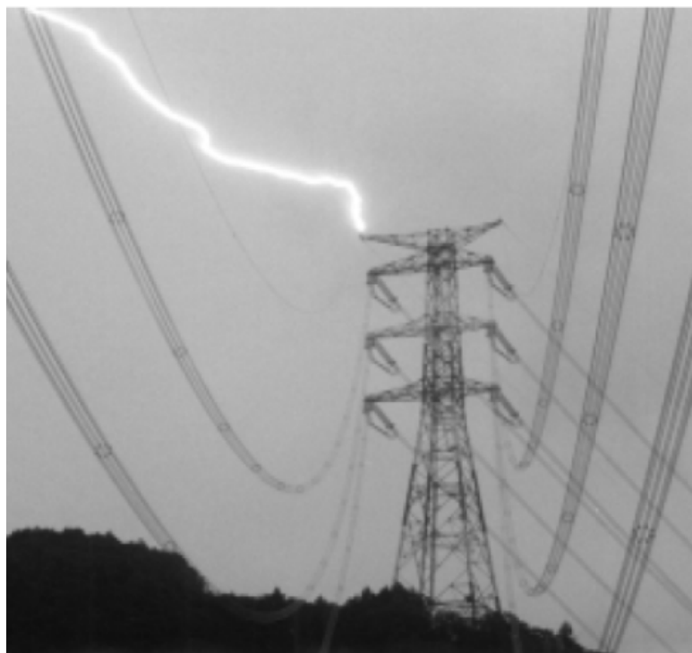
Rys. 6. Uderzenie pioruna w przewody odgromowe linii [105].
