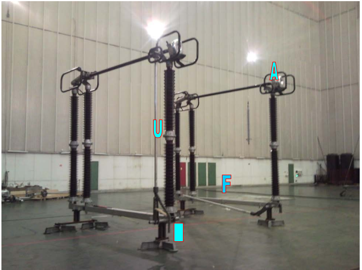
Rys. 37. Odłącznik 420 kV w Laboratorium Wysokich Napięć IEN.
