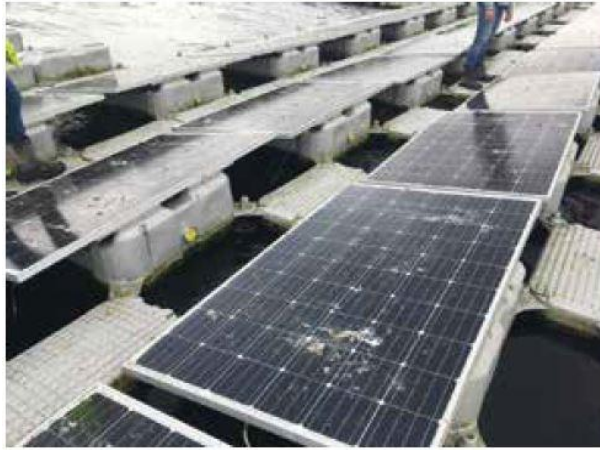
Rys. 10. Zabrudzenie paneli fotowoltaicznych Fig. 10. Contamination of photovoltaic modules
