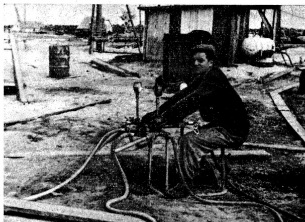
Rys. 3. Stacyjka rozdzielczą sprężonego powietrza (bateria kranów).
