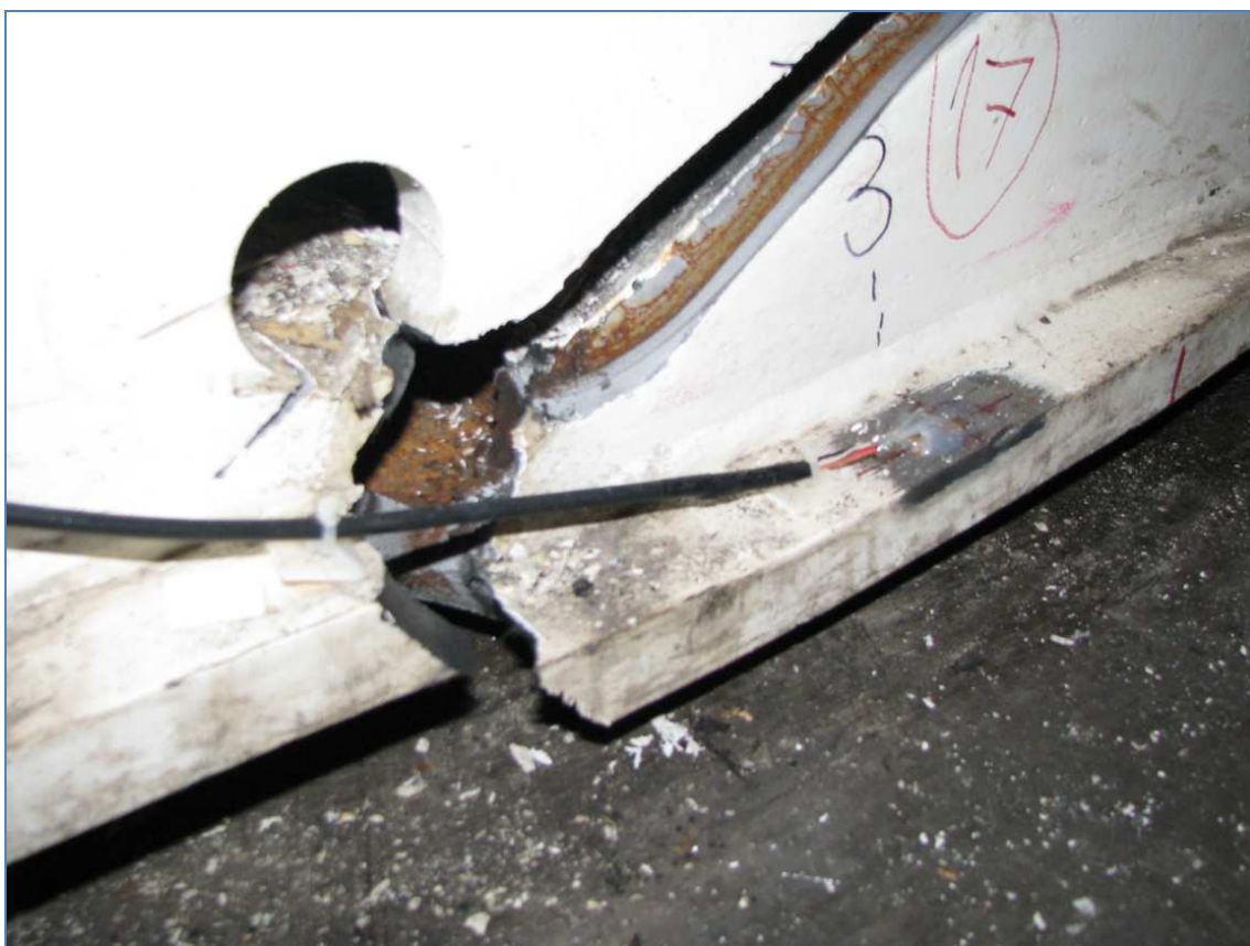
Rys. 6.4. Miejsce pęknięcia na spągnicy w okolicy otworu odpływowego
