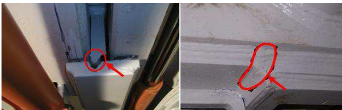
Rys. 3.7. Pęknięcia zmęczeniowe w strefach występowania karbów złożonych w stropnicy wychylnej
