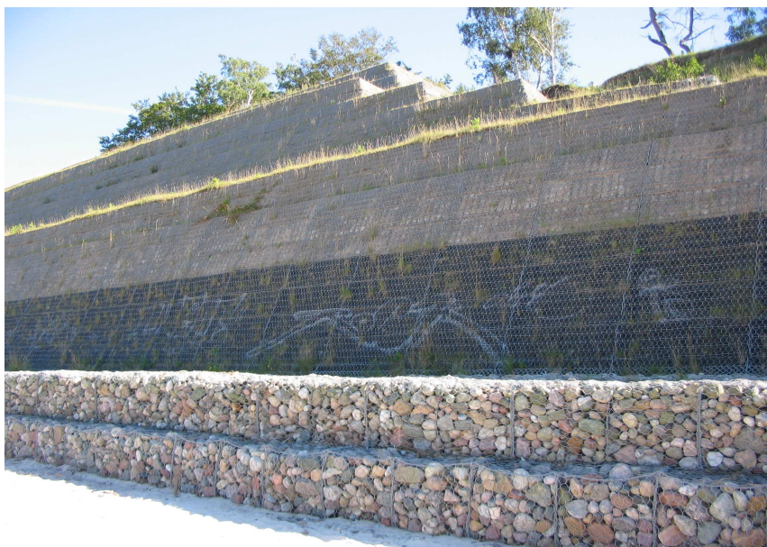
Rys. 2.1. Ogólny widok ściany oporowej wykonanej z koszy siatkowych MACCAFERRI , chroniącej brzeg morski w Jastrzębiej Górze (fot. wyk. przez autora)
